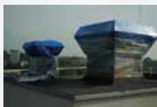
Uszczelnienia wentylatorów i central wentylacyjnych
